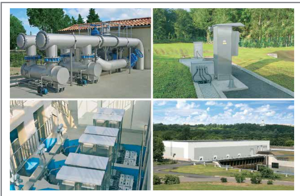
Рисунок 2. Примеры УФ-обеззараживания сточных вод: г. Оранж (Франция), г. Шатоле (Франция), г. Гуми (Южная Корея), Москва (Россия) Figure 2. Examples of wastewater UV disinfection plants: Orange (France), Chateaulin (France), Gumi (South Korea), Moscow (Russia)
